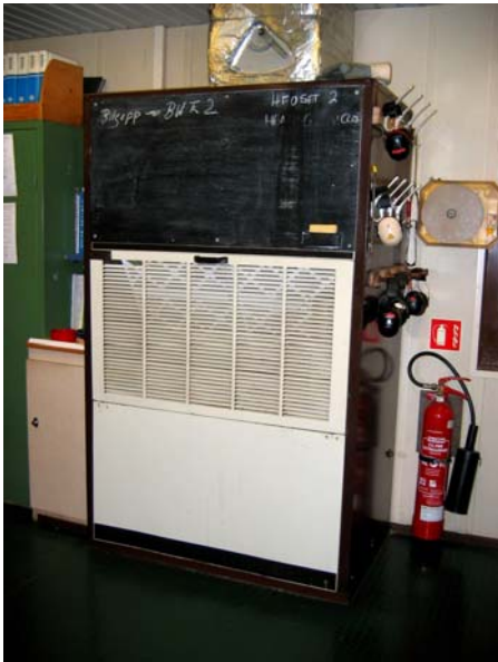
Abbildung 2: Klimabox im Maschinenkontrollraum.
