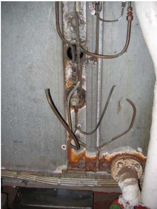
Abbildung 11: Hygienemängel an einem Luftbefeuchter.
