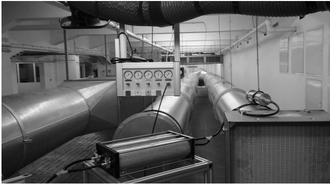
Bild 2. Partikelgeneratoren und Staubkanäle.
