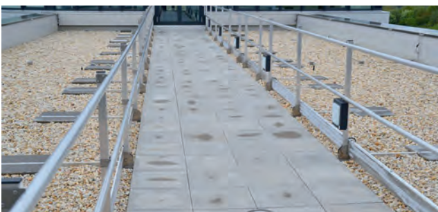
Abb. 9: Seitenschutzsysteme und Geländer zur Sicherung von Personen in absturzgefährdeten Bereichen nach DIN EN 13374
